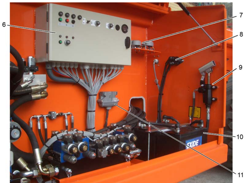
Ventiler og generator
